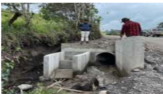
Obras complementarias de control del caudal acequia Güitig, parroquia Machachi, cantón Mejía.
