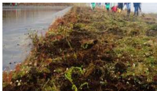
Reservorio de la comunidad Las Compañías, parroquia Cangahua, cantón Cayambe. Impermeabilización con geomembrana y reforestación en la rivera del reservorio
