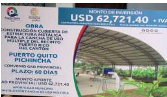
Colocación de cubierta de estructura metálica para la cancha de uso múltiple del recinto Puerto Rico
