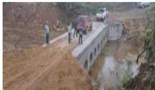
Alcantarilla en batería sobre el Río Piedritas, vía Ventanas - San Francisco de La Caoni
