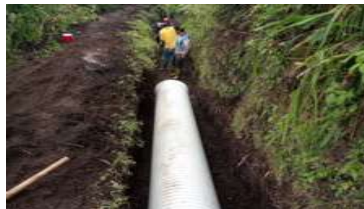
Instalación de tubería por cogestión, sistema de riego La Pirca, parroquia San José de Minas, cantón Quito
