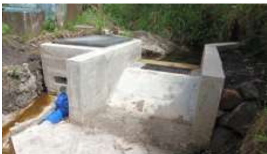
Trabajos por cogestión para el mejoramiento de la conducción del sistema de riego de la junta Ventarrón La Trabana, parroquia El Quinche, cantón Quito
