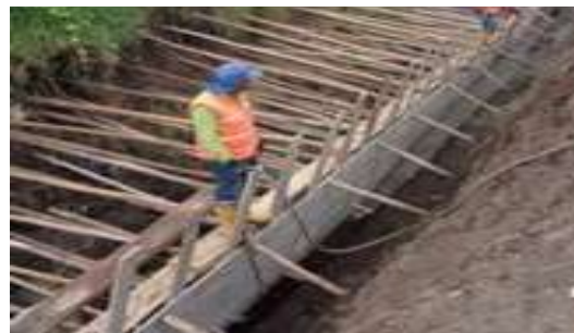
Mejoramiento del canal principal sistema de riego El Pisque, cantones Cayambe y Distrito Metropolitano de Quito.
